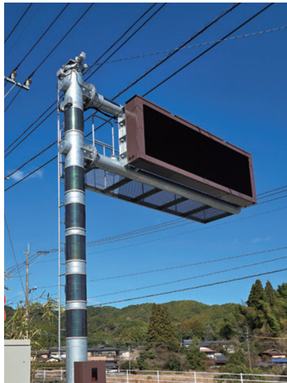
▲道路情報板の上部や支柱にカルコパイライト太陽電池を設置
