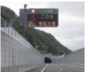
トンネル防災システム
