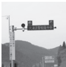
津波警報表示板
